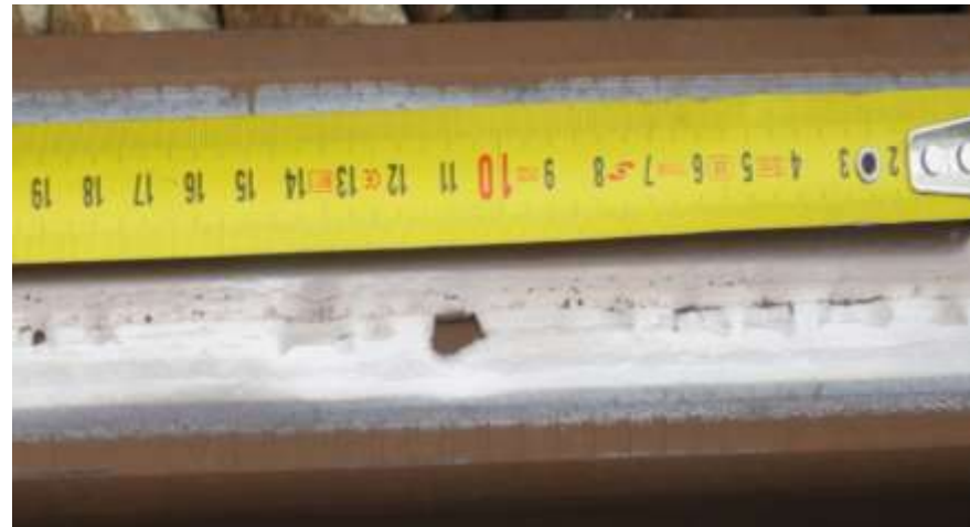
RCF scheurvorming en uitbrokkeling aan binnenbeen. Oriëntatie duidt op dominant laterale slip.
